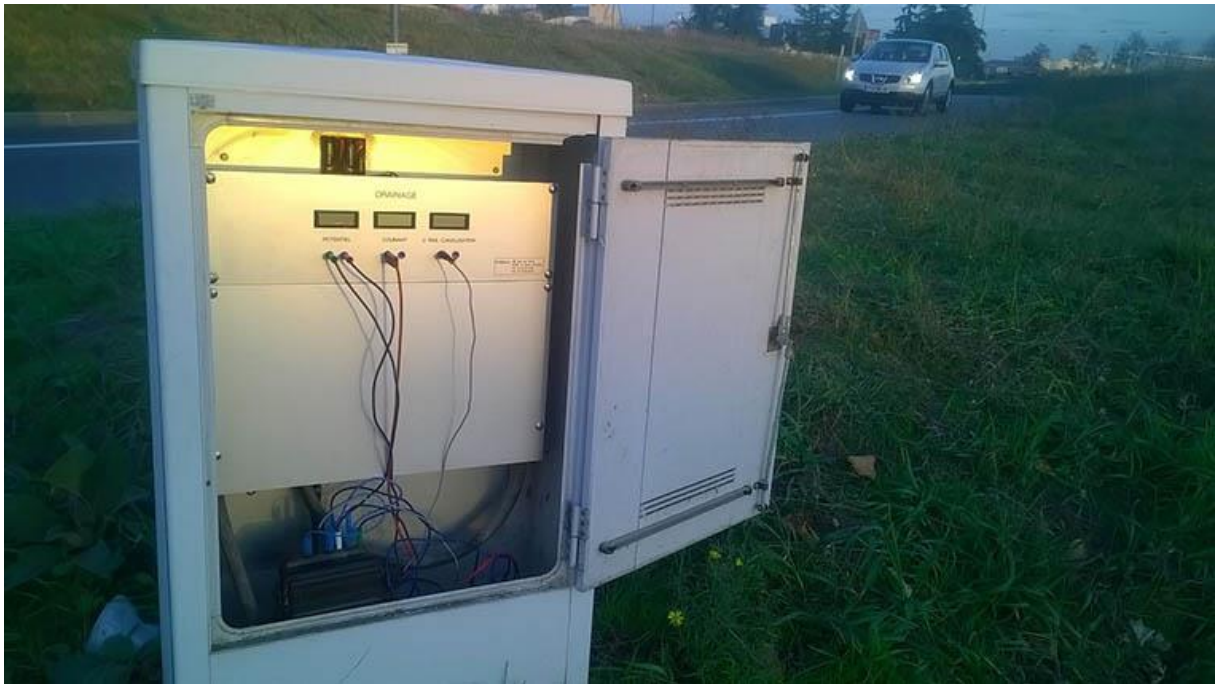
Figure 2 poste drainage de courant vagabond
