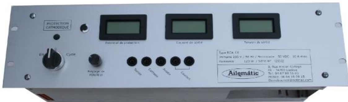
Figure 1 poste soutirage redresseur protection cathodique ailematic
